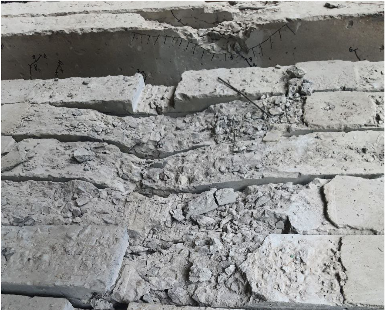
Рис. 2.9. Фізично зруйнована стиснута зона бетону залізобетонних балок
