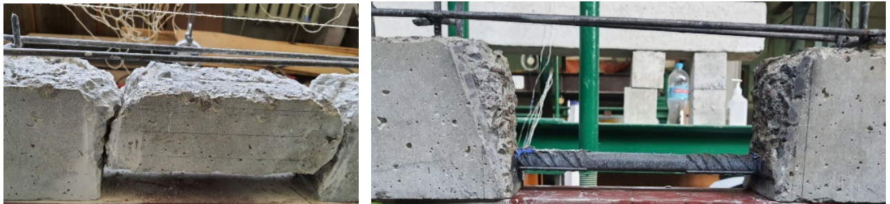
Рис. 2.29. Вигляд зруйнованої ділянки залізобетонної балки
