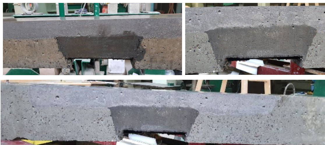
Рис. 2.32. Кінцевий вигляд відновленої залізобетонної балки методом вкладання дрібнозернистого бетону та відновлення стиснутої зони бетону
