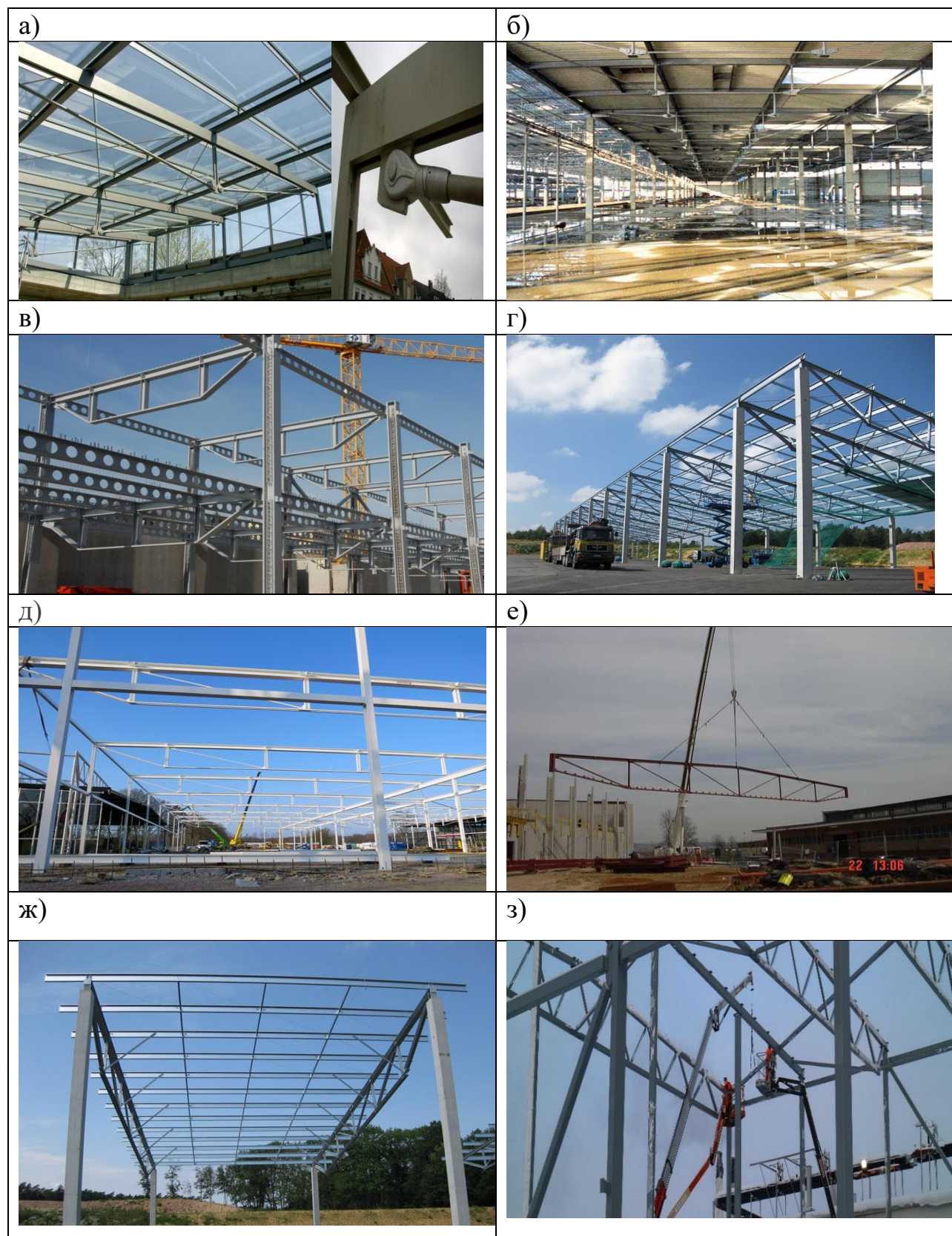
Рис. 1.2. Сталеві фермові конструкції покрить за кордоном: а - одностояковий сталевий шпренгель прольотом 12 м, Німеччина [18]; б - двостояковий сталевий
