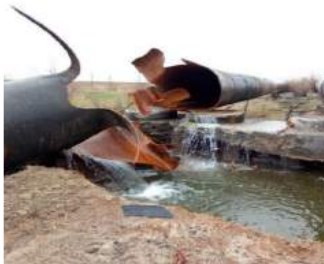
Рис. 1. Пошкоджений водогін «Дніпро-Миколаїв», 2022 р.
