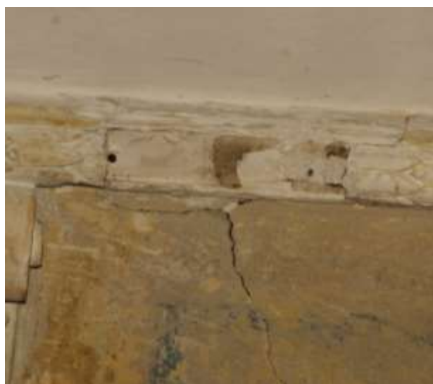
Рис. 7. Тріщини на поверхні склепін'я і втрата ліпного декору стелі. Зонд перед консервацією, 2012 р. Фото С.Гетьманчука.
