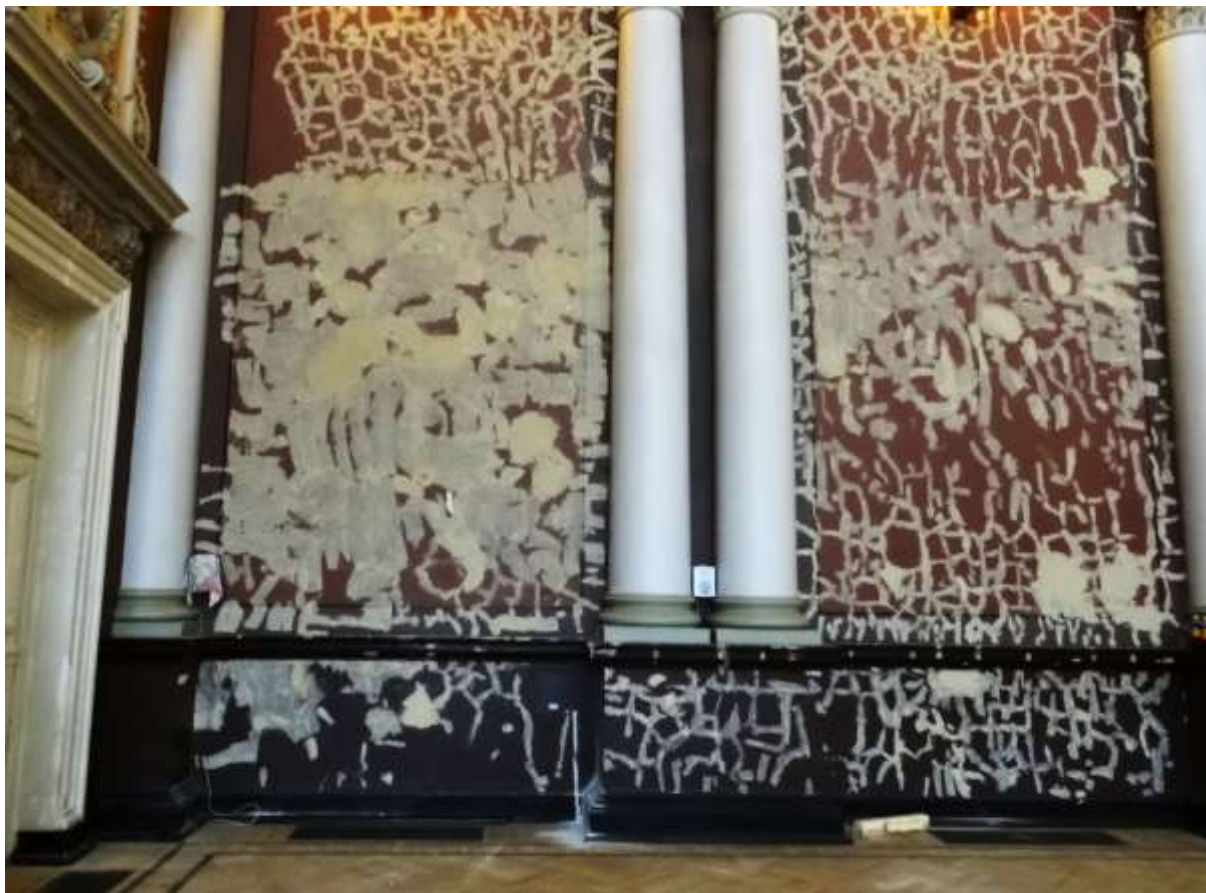
Рис. 9. Стан стін актової зали (міжколонні простінки північної стіни) з шпаклюванням тріщин у тиньку, 2014 р. Фото М.Бевза.
