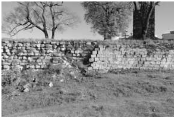
Рис. 10. Фіксація стану збереження оборонних споруд монастиря оо. Домініканів у Підкамені. Оскарпування північно-західного бастіону кліщевої системи (світлина авт. 2018 р.)
