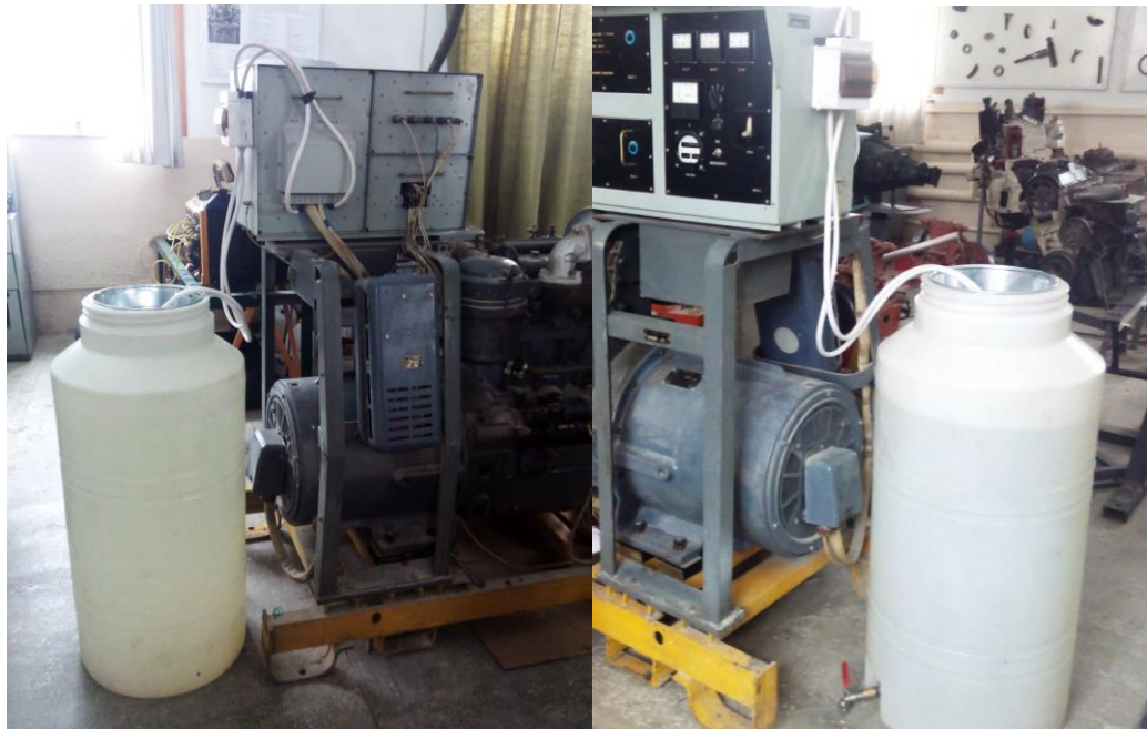
Рисунок 3.3 – Резервуар з водою об'ємом 200л із зануреними в неї електронагрівачами
