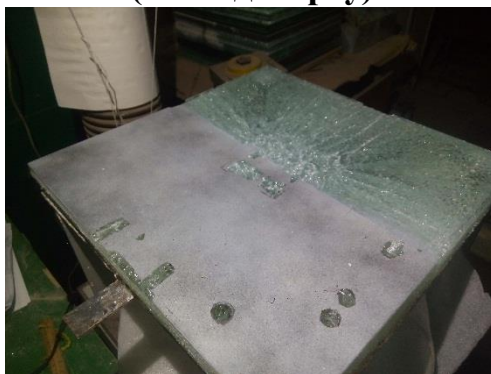
ПСБ-4.1, зруйновані всі шари (вигляд зверху)
