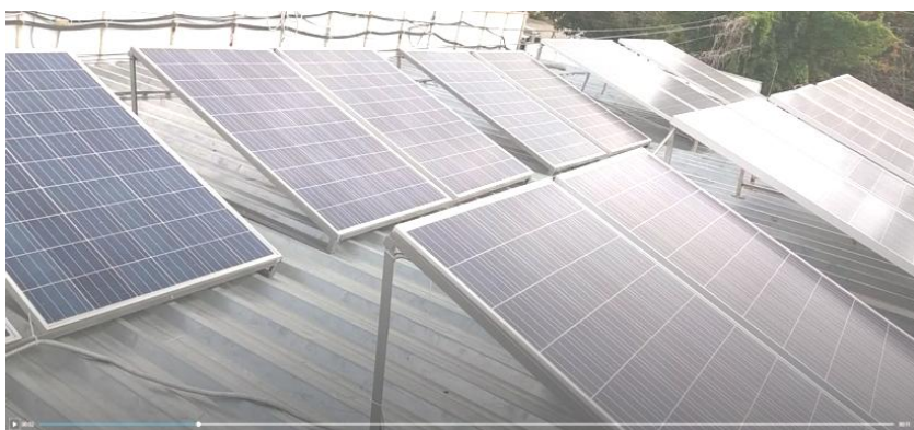
Рисунок 6.1 – Загальний вигляд панелей сонячної мережевої електростанції потужністю 30 кВт розташованої на даху
